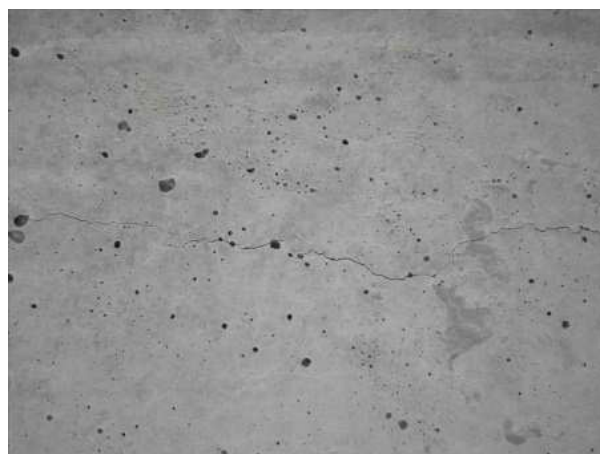
Résultats : Fissure de 0.2 mm
